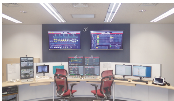
地域冷暖房中央監視室
